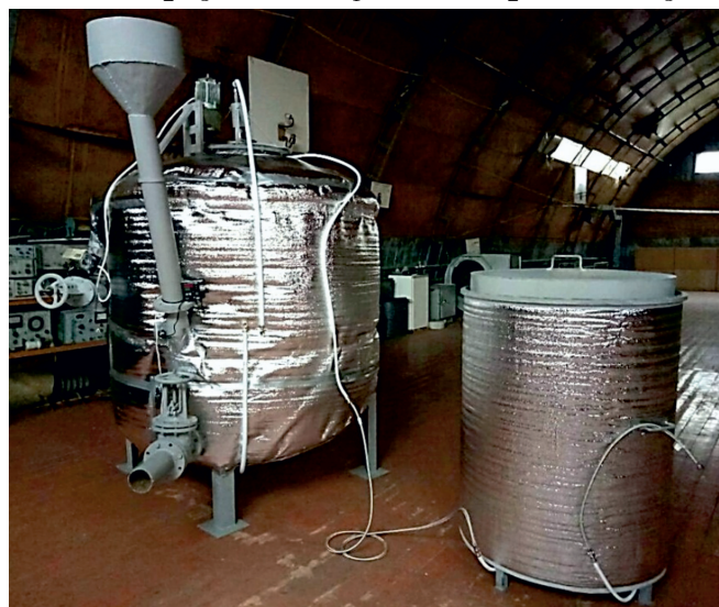
Рис. 1. Общий вид биогазовой установки
